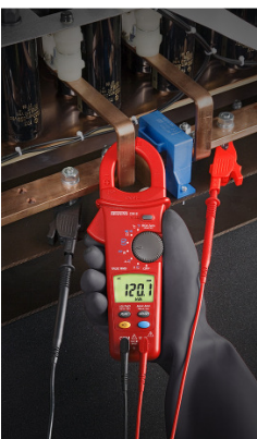
BENNING CM 8 Leistungsmessung am Leistungsteil eines DC/ AC-Umrichters
