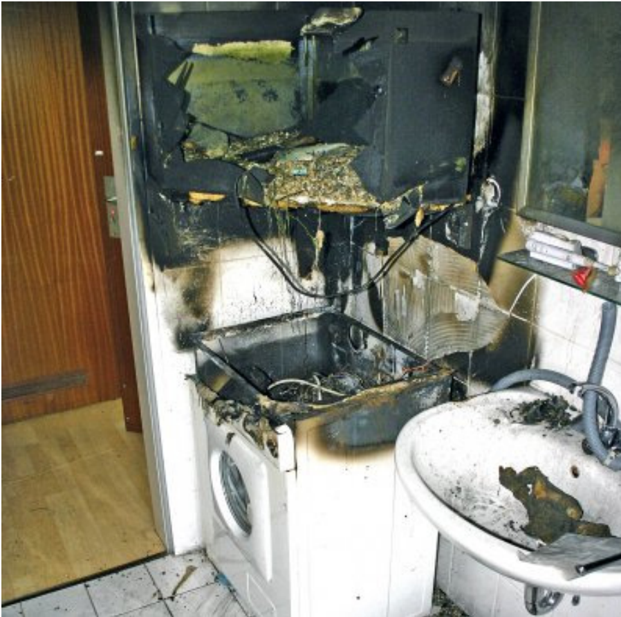
Bild 1: Brandursache Wäschetrockner Quelle: Schadenprisma 3/2009 - IFS
