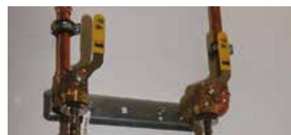
Belastungs- und Dichtheitsprüfung oder Leckmengenmessung mit Y-Verteiler zur gleichzeitigen Messung der Verteiler- und Verbrauchsleitung
