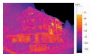
Wärmebild mit testo ScaleAssist
