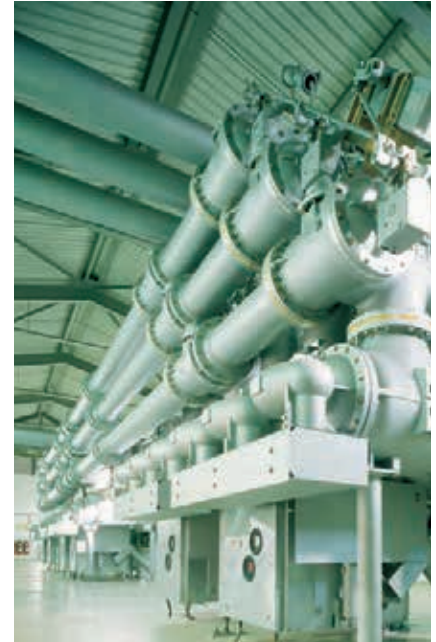
In der Hoch- und Mittelspannung dient SF6 zur Vermeidung von Schaltfunken. testo 6740 überwacht kontinuierlich die Feuchte – so können die Austauschzyklen des teuren Gases maximiert werden; Schäden werden vermieden.
