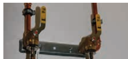
Belastungs- und Dichtheitsprüfung oder Leckmengenmessung mit Y-Verteiler zur gleichzeitigen Messung der Verteiler- und Verbrauchsleitung
