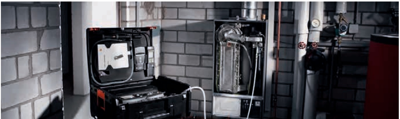
Automatische Gebrauchsfähigkeitsprüfung mit Einspeisevorrichtung mit Anschluss an die Gastherme
