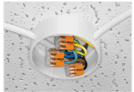
Leuchtenverteilung in Deckenbaldachin
