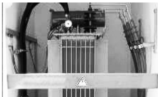
Benachbarte, unter Spannung stehende Teile abdecken oder abschränken
