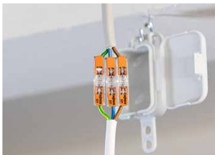
Leuchtenanschluss in Zwischendecken
