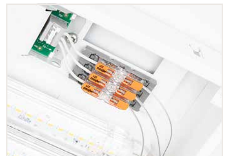
Mehrpolige, lagefixierte Verdrahtung einer Leuchte
