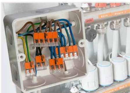
Verdrahtung feindrähtiger Leiter in Installationsdosen
