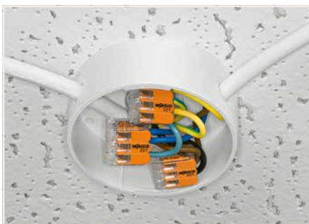
Leuchtenverteilung in Deckenbaldachin
