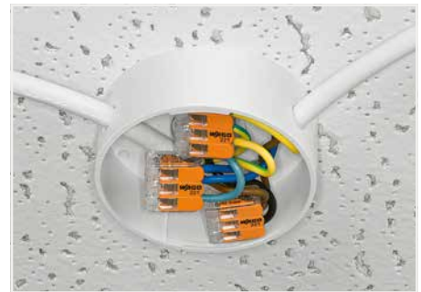
Leuchtenverteilung in Deckenbaldachin
