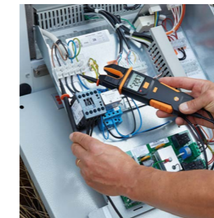
Spannungsmessung an einem Verdichter.
