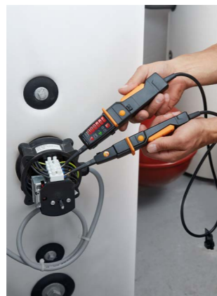
Spannungsmessung an einem Heizlastspeicher.
