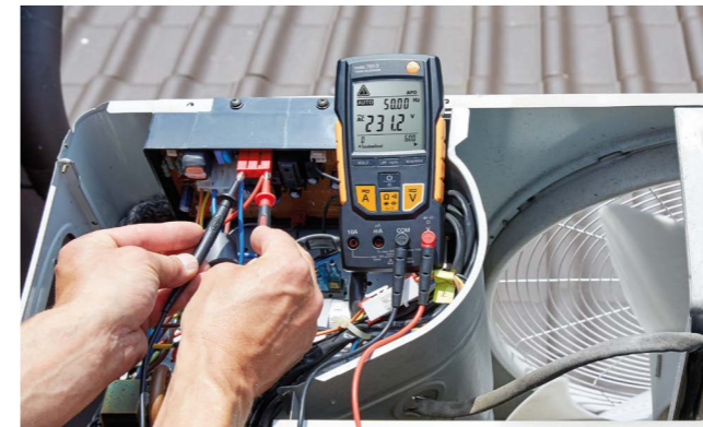
Spannungsmessung an einer Kälte-Außeneinheit mit testo 760 .
