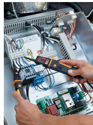
Spannungsmessung an einem Verdichter.
