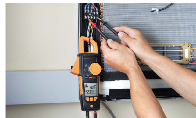
Spannungsmessung an einem Klimagerät mit testo 770 .
