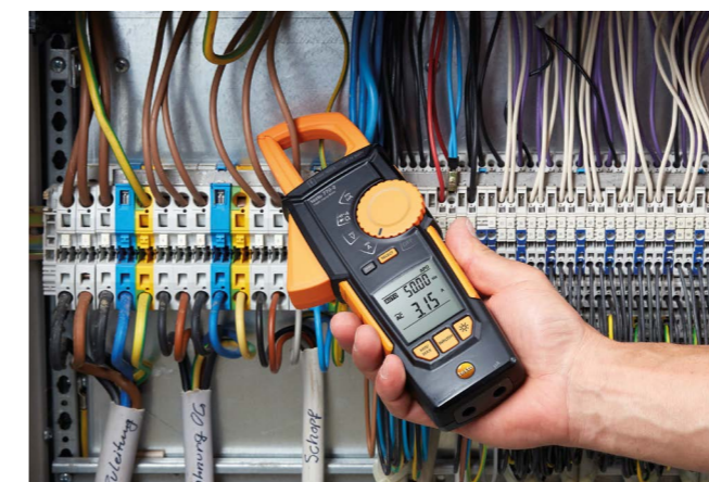
Strommessung am Schaltschrank.
