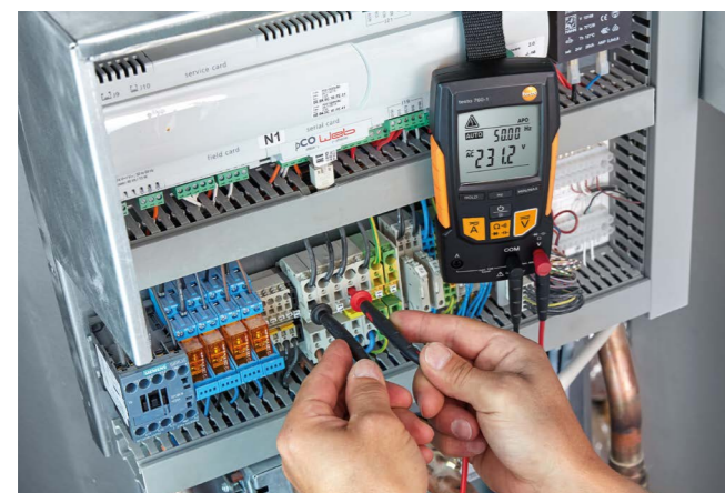
Spannungsprüfung am Schaltfeld einer Wärmepumpe.
