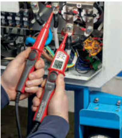
Prüfung der Ausgangsspannung einer DC-Ladeeinrichtung
