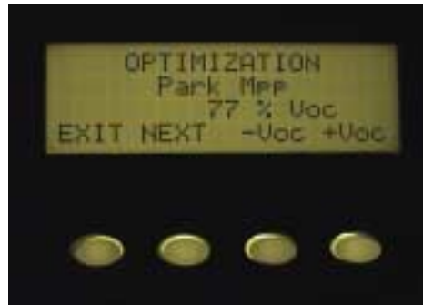
Bild 26 – feste Eingangsspannung (Park Mpp)
