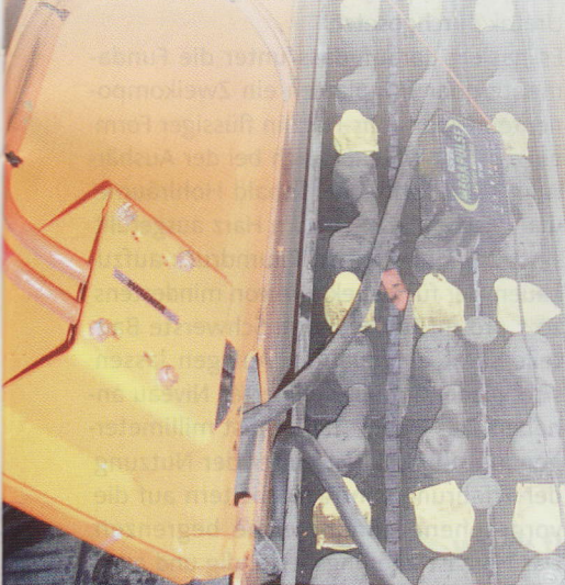
Batteriepulser angebaut an eine Traktionsbatterie.
