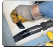
... den gerissenen Schlauch unter Spannung umwickeln
