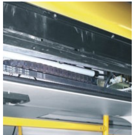
Schiebetür in der U-Bahn mit igus® Chainflex® CF9 Leitung für kleinste Bauräume
