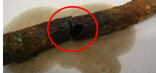
Stahlrohre rosten stellenweise durch
