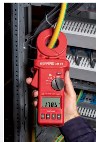
Messung des Betriebsrdes einer Industrieverteilung
