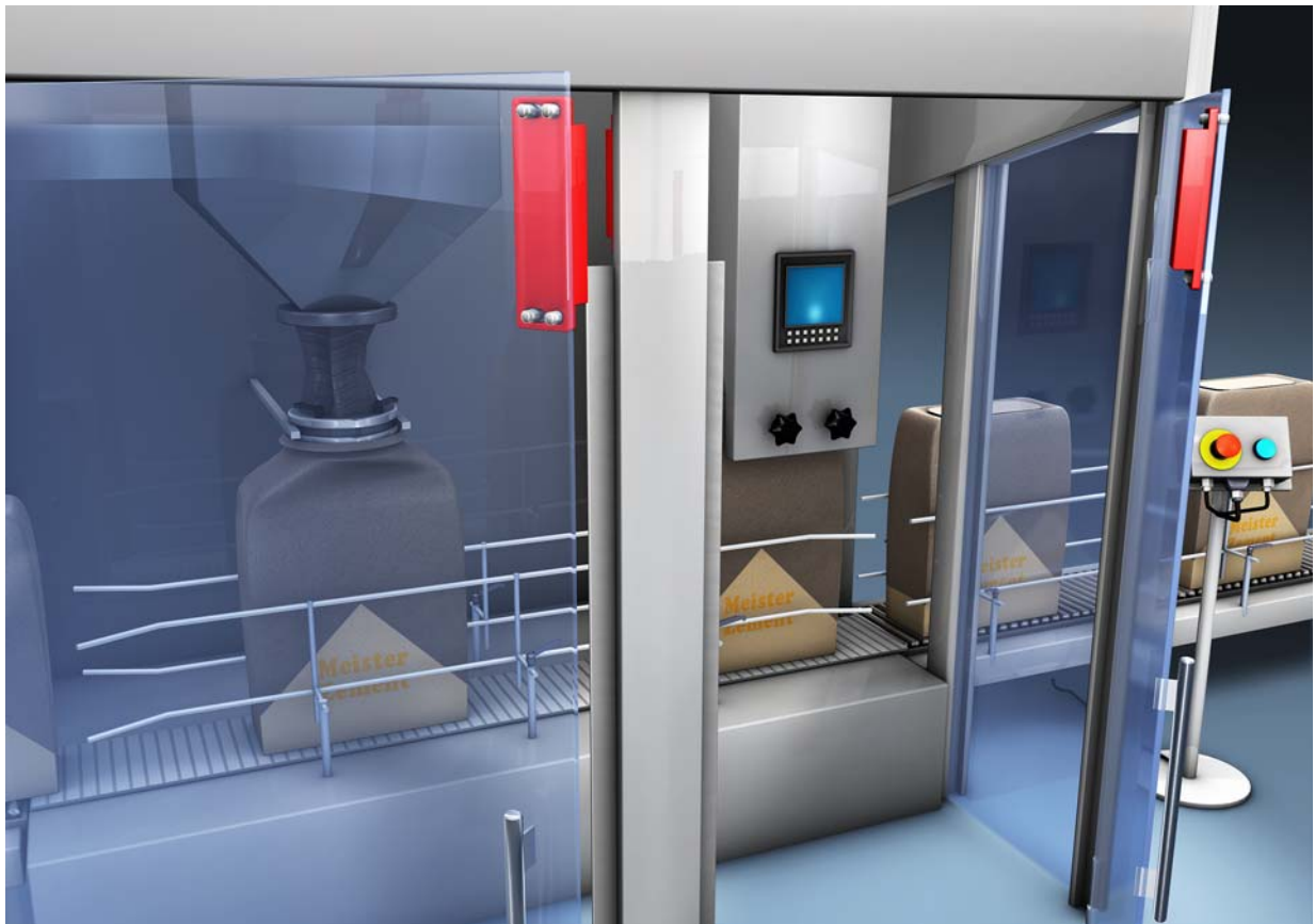
Bild 5.2: Zugangssicherung an einer Abfüllanlage, realisiert an einer Tür mit MC388x Sensoren
