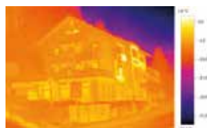
Wärmebild ohne testo ScaleAssist
