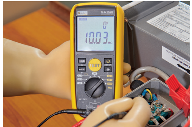
Vorbeugende Wartung an einem Motor
