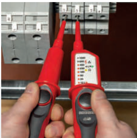
Drehfeldprüfung an den Ausgangsklemmen einer USV
