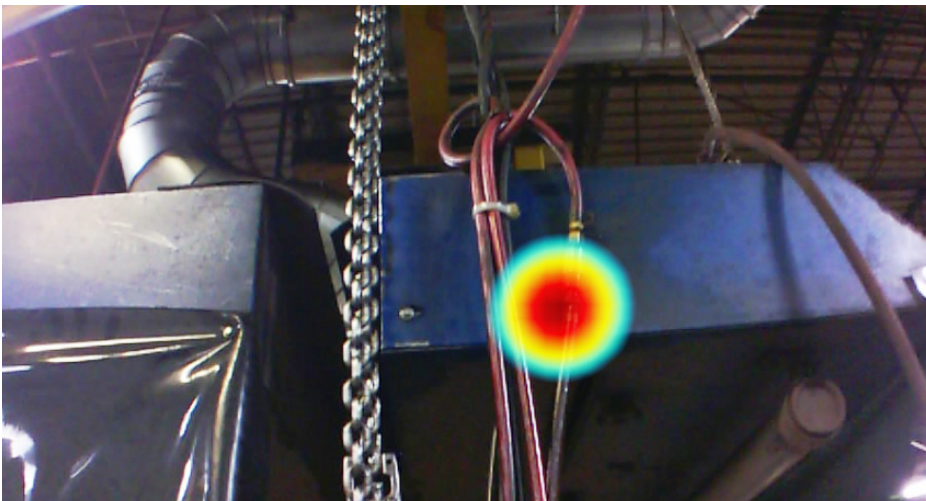
Industrie-Schallkamera ii900 bei der Erkennung eines Luftlecks in einer industriellen Umgebung.
