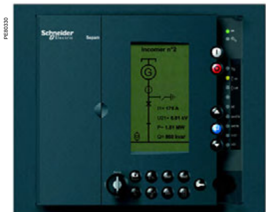
Commande locale à partir de l'IHM synoptique.
