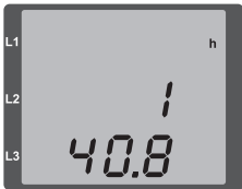
Abb. Anzeige Betriebsstundenzähler (Messwertanzeige A20), Beispiel 140,8 h
