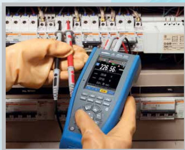
Medidas en cuadros eléctricos
