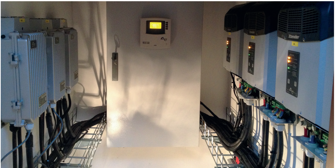
Sistema de autoconsumo para edificio industrial
