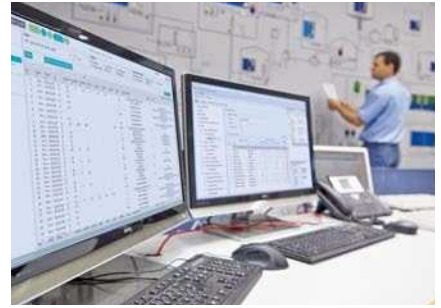
Telecontrol: transmisión segura y continua de datos de proceso a la sala de control
