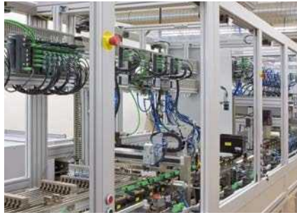
Mantenimiento remoto: acceso directo a sistemas de control y redes Ethernet
