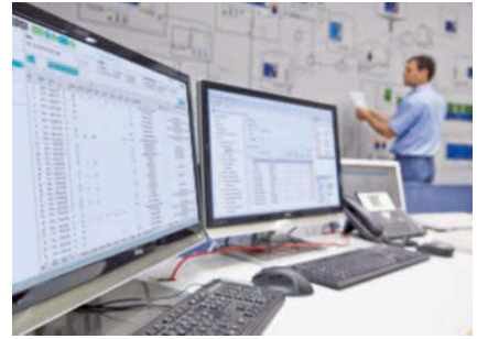
Téléexploitation : transfert sécurisé et continu des données de processus à la centrale de commande
