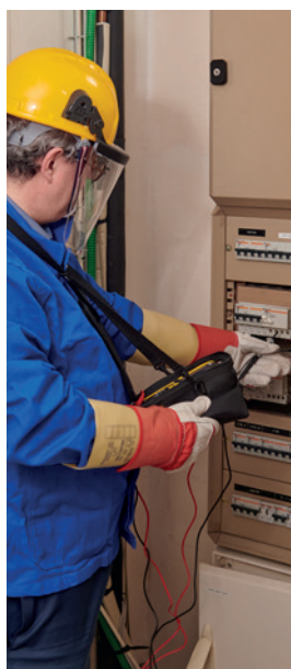
Controllo di un quadro elettrico
