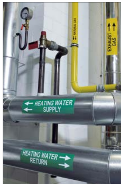
Duidelijk leesbare markering van leidingwerk.
