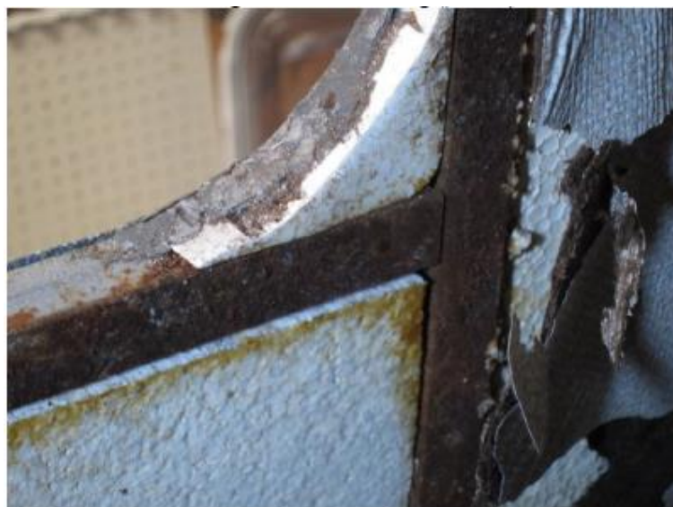
Izolacija in kovinski okvir na starejši počitniški prikolici
