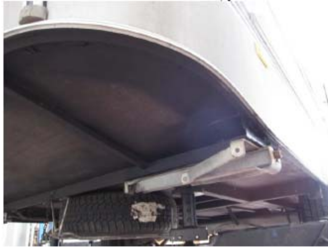
Dno počitniške prikolice: tukaj masivna iverna plošča, slabo zaščitena
